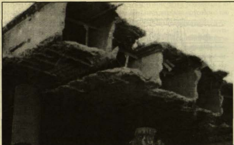
Φωτ. 6. Κατάρρευση αυτοκινητοδρόμου I-10 επί της λεωφόρου Λα Τσιενέγκα.
