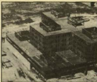
Φωτ. 1. Το νέο νοσοκομείο «Ολιβ Βιου» στο Σιλμάρ κατά τη διάρκεια της κατασκευής του: Φέρων οργανισμός
