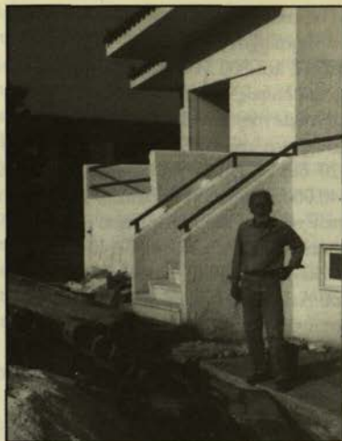
Σχ. 4. Οι σωληνώσεις του γεωθερμικού εναλλάκτη επεκτείνονται από τη γεώτρηση μέχρι την αντλία θερμότητας στο εσωτερικό της κατοικίας στον Άγιο Δημήτριο Κορωπίου.
