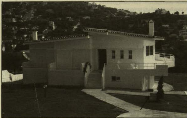
Σχ. 5. Ο γεωθερμικός εναλλάκτης βρίσκεται σε γεώτρηση στη γωνία του πλακόστρωτου κοντά στο δένδρικό (όπως δείχνει το βέλος). Είναι μία πηγή ενέργειας, που καταργεί το ρυπογόνο πετρέλαιο, ενώ, ακόμη προσφέρει και ψύξη.
