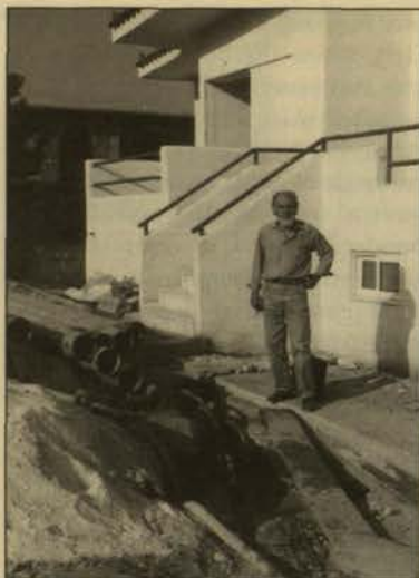
Σχ. 4. Οι σωληνώσεις του γεωθερμικού εναλλάκτη επεκτείνονται από τη γεώτρηση μέχρι την αντλία θερμότητας στο εσωτερικό της κατοικίας στον Άγιο Δημήτριο Κοροπιού
