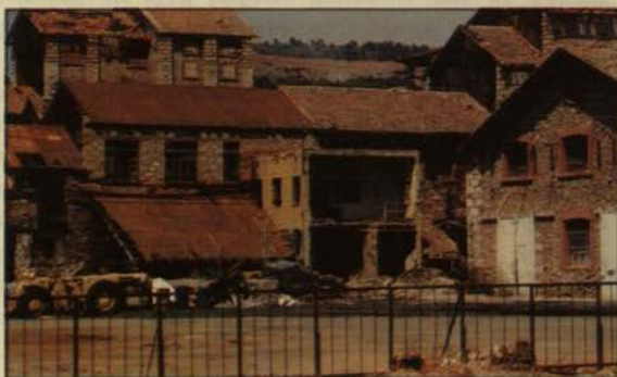
Μέρος των εγκαταστάσεων της Γαλλικής Εταιρείας που έχουν κηρυχθεί διατηρητέες. Η κατασκευαστική αποτύπωση και αποτίμηση των αναγκών για άμεσες σωστικές επεμβάσεις αποτελεί βασική προτεραιότητα για οποιαδήποτε μελλοντική επαναχρησιμοποίησή τους
