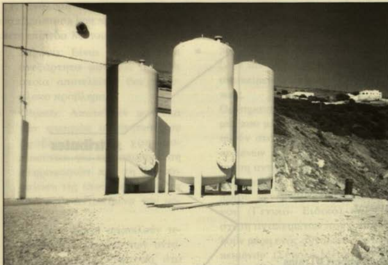
Σύστημα μετακατεργασίας νερού
