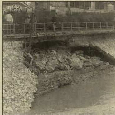
Αστοχία πρηνών, Ν. Ιωνία 1994 - ΦΩΤΟ 3
