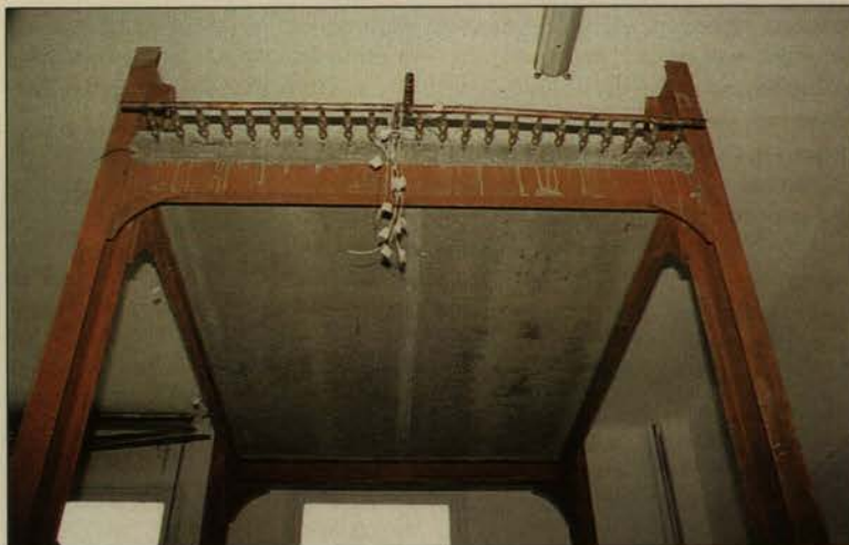
Σχήμα 1. Πλάκα οροφής με διανομέα και ψυκτικούς σωλήνες, πάνω σε μεταλλικό πλαίσιο στήριξης.
